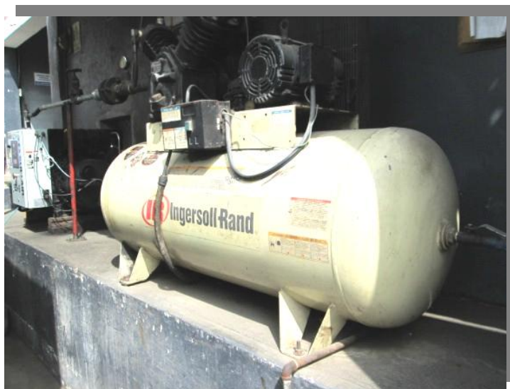
Compresor Industrial de Aire
