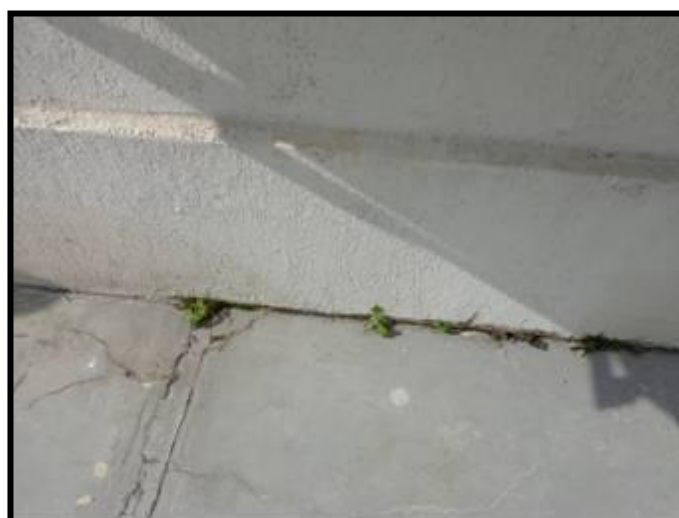
Brotamento de vegetação no pavimento de cobertura
