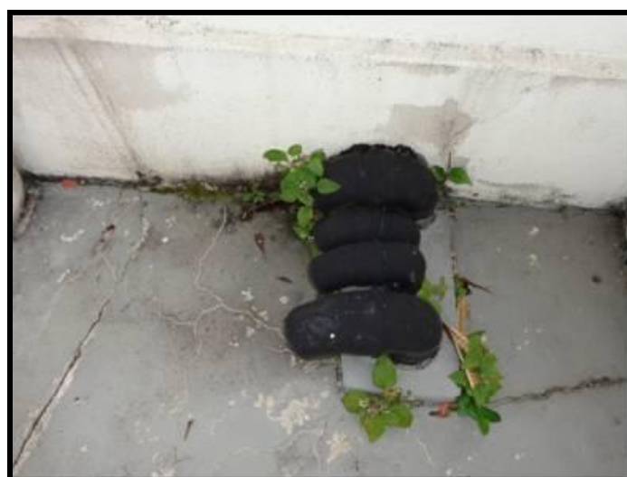
Brotamento de vegetação no pavimento de cobertura
