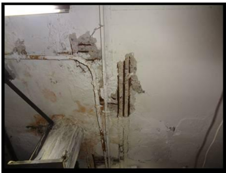
Patologias na armadura das lajes em garagem
