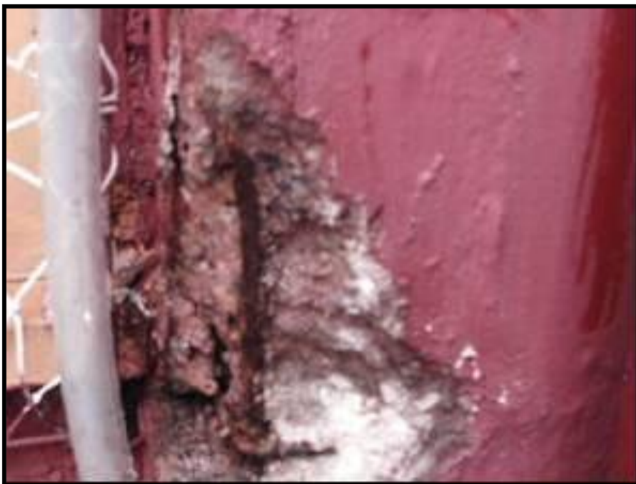
Desprendimento de revestimento e corrosão das armaduras em edificação à beira mar
