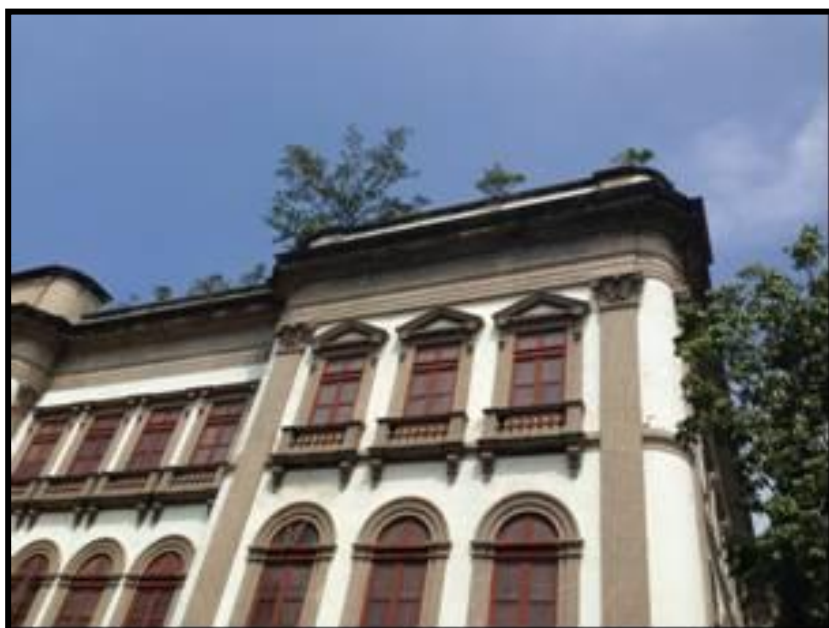
Edificações históricas danificadas e sem manutenção apresentando brotamento de vegetação.
