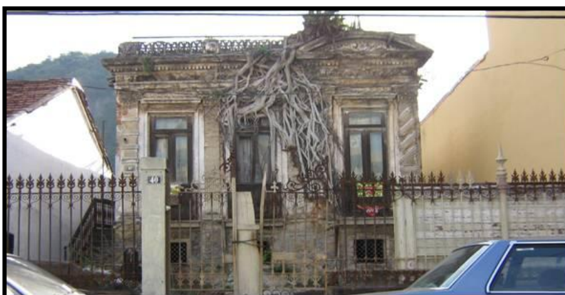
Edificações históricas danificadas e sem manutenção apresentando brotamento de vegetação.
