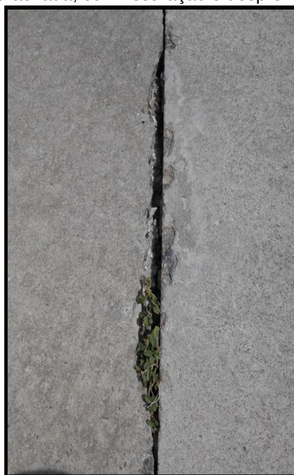
Brotamento de vegetação na junta de dilatação de estacionamento descoberto
