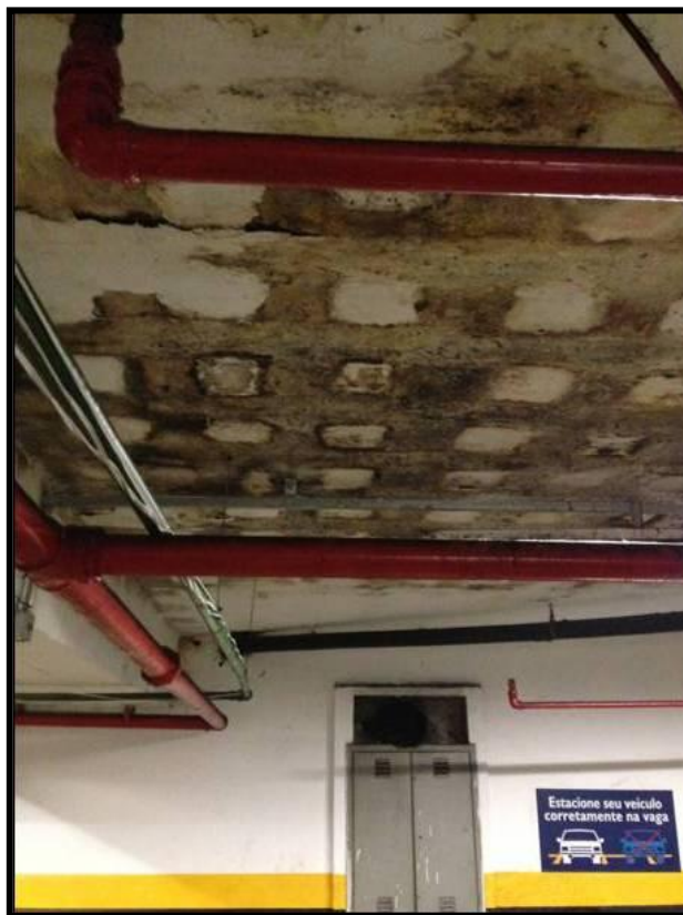
Patologias na armadura das lajes em garagem
