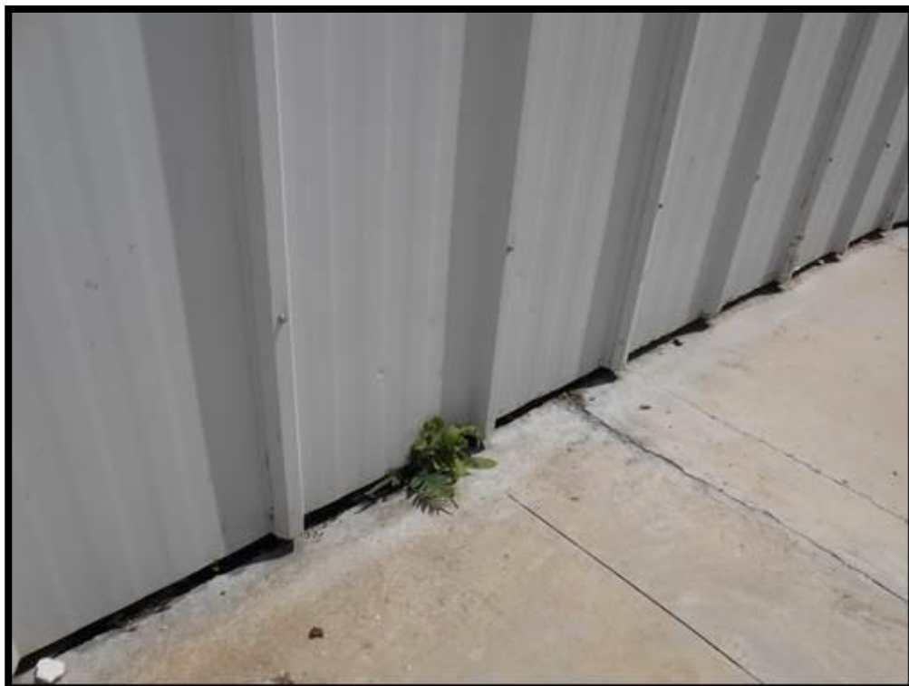
Brotamento de vegetação em pavimentos expostos às intempéries.
