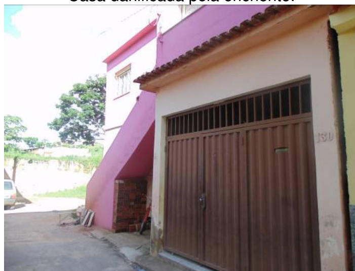
Casa danificada pela enchente.
