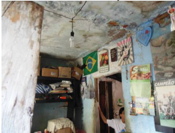
Interior de uma casa com várias infiltrações devido ao sinistro.
